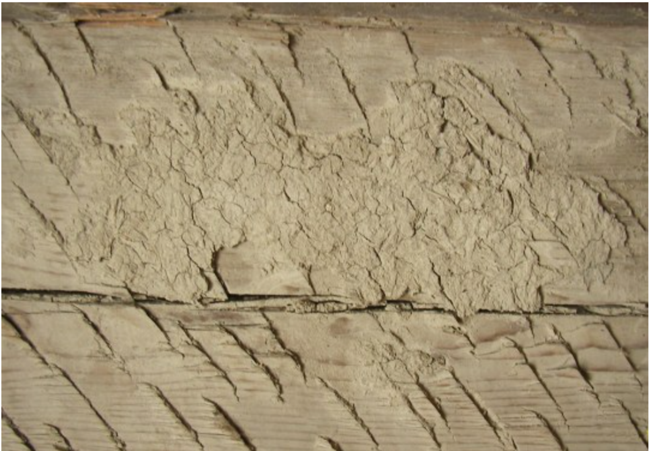
Savirappauksen jäänteitä lastutussa hirsipinnassa.
