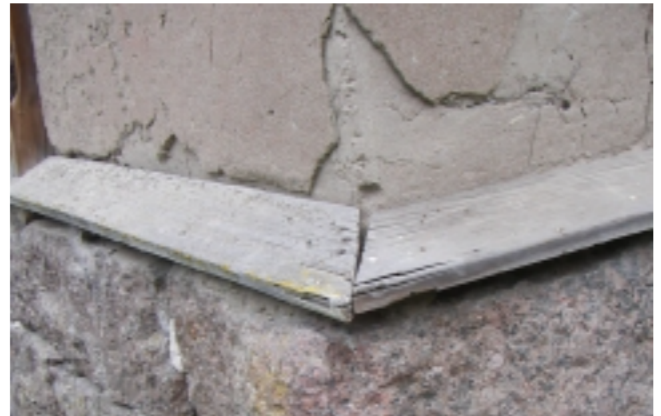
Puulista vanhassa savirakennuksessa. Rapautunut savirappaus joudutaan uusimaan, jotta listan ja seinän saumakohta saadaan tiiviiksi.
