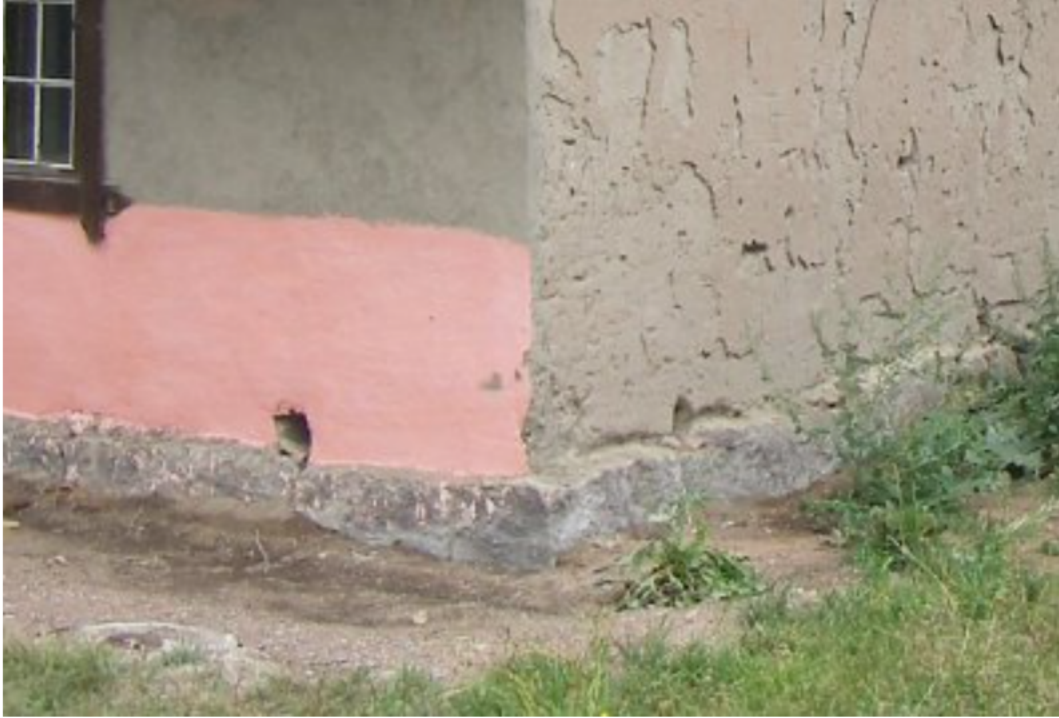
Vasemmalla kunnostettua savirappausta ja kalkkimaalilla tehtyä koemaalausta. Kulman oikea puoli on kunnostamatta.
