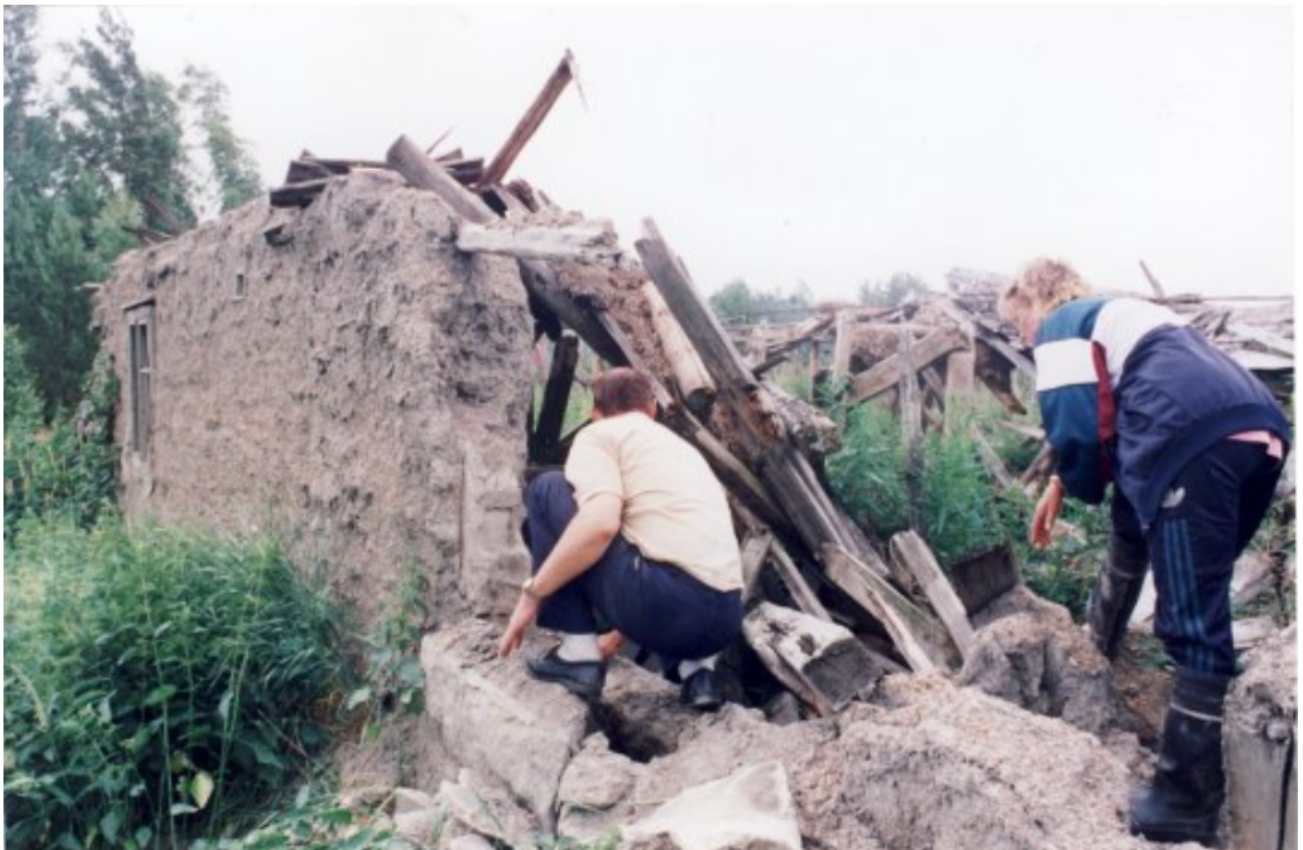
40 vuotta ilman kattoa on koitunut savirakennuksen kohtaloksi.
